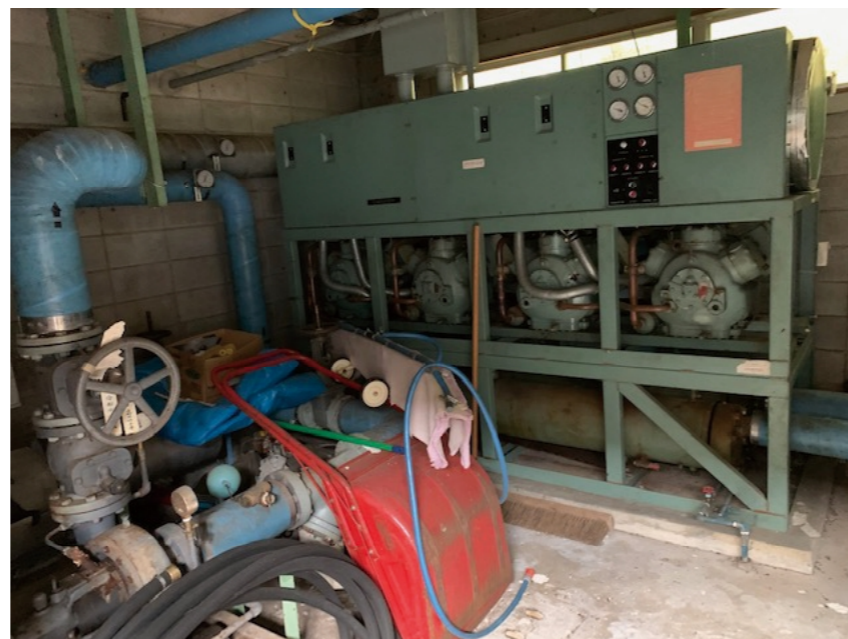
冷凍機・ポンプ
