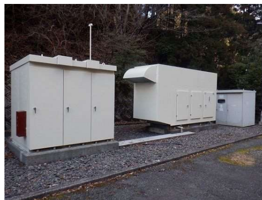
【非常用自家発電設備(相ノ浦浄水場)】
