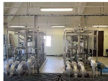
【富貴浄水場：膜ろ過設備】
