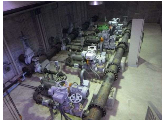
【送水ポンプ(高野山浄水場)】
