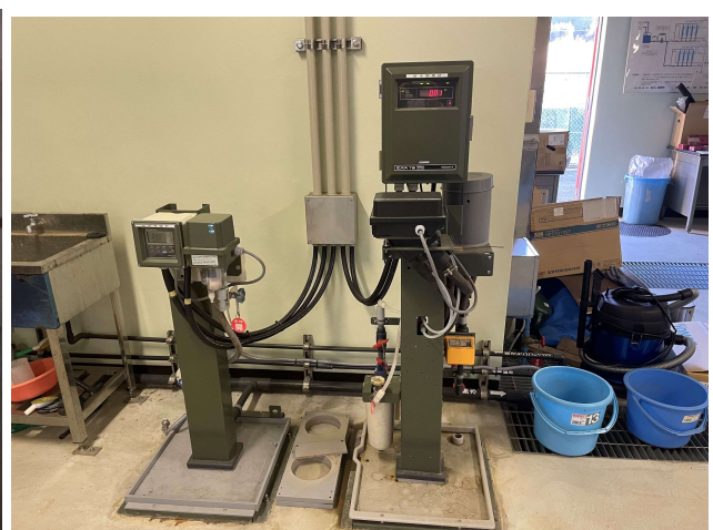
【水質自動計測装置(富貴浄水場)】
