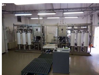
【相ノ原浄水場：膜ろ過設備】
