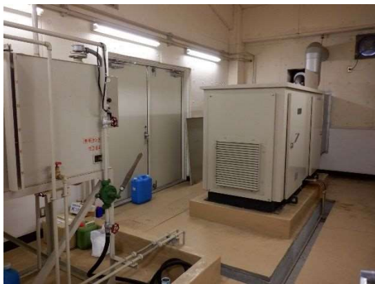
【非常用自家発電設備(高野山浄水場)】
