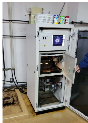
【魚類監視水槽(高野山浄水場)】
