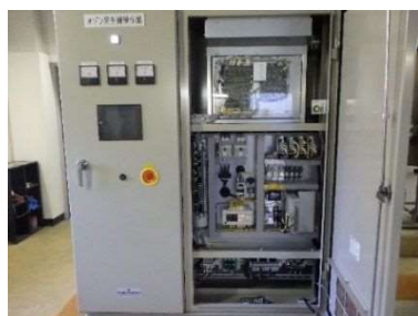
【高野山浄水場：オゾン処理設備】
