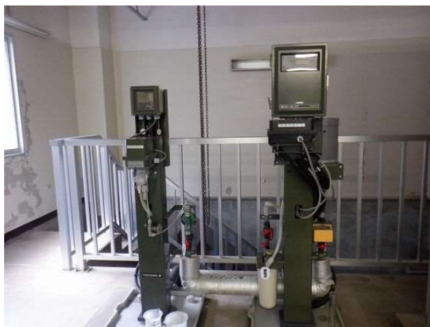
【水質自動計測装置(相ノ浦浄水場)】
