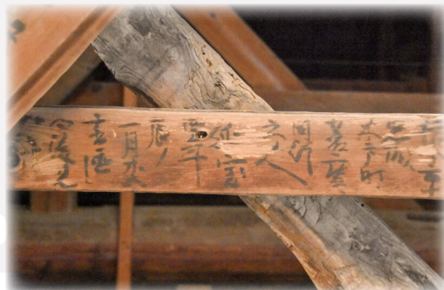
天井裏の落書き ▲
